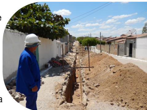
Rede sendo implantada
