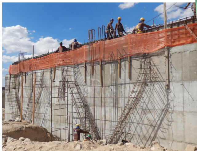
Reator da ETE Tacaimbó
