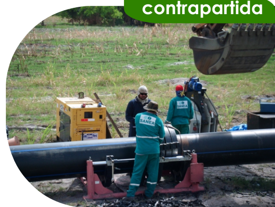
Trecho da Adutora de Porto de Galinhas
