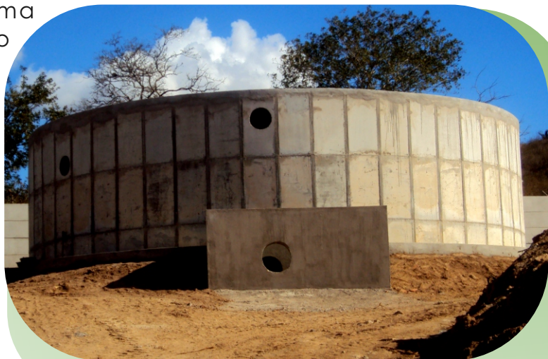
Reservatório da ETA Bezerros
