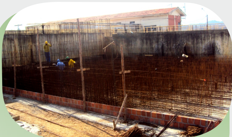
Floculadores da ETA Bezerros
