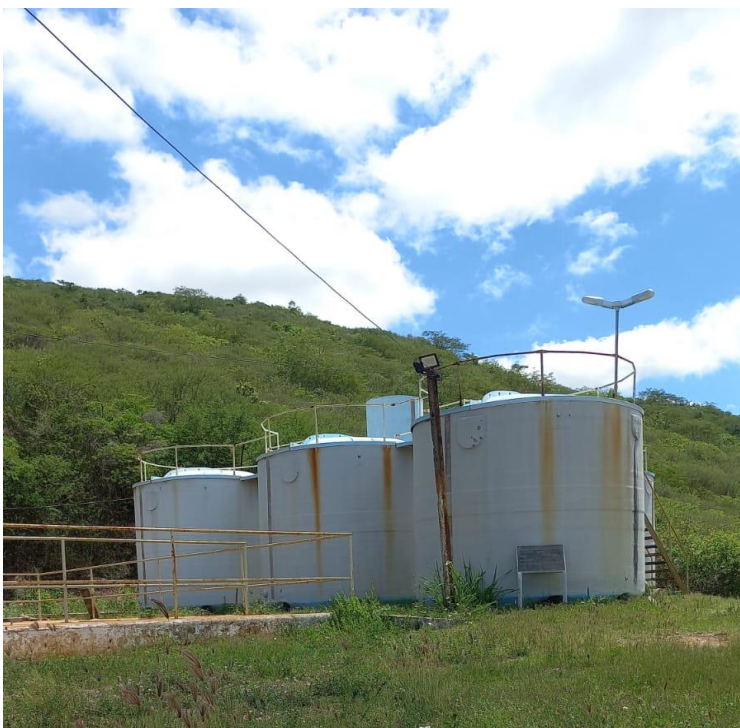
Figura 08: Foto dos filtros ascendentes da ETA-Afetos.
