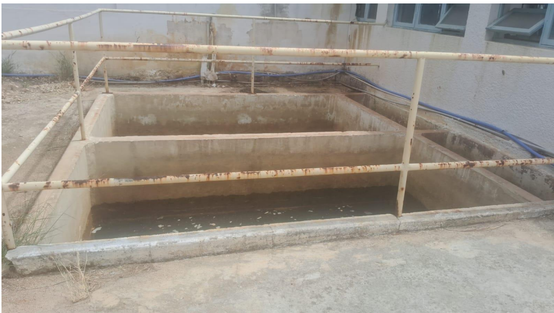
Figura 10: Foto dos filtros descendentes da ETA-Afetos.
