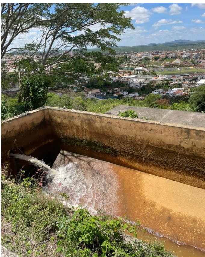
Figura 06: Foto do tanque de lavagem da ETAR-Afetos, visto por outro ângulo.
