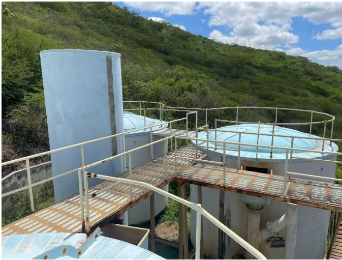
Figura 09: Foto dos filtros ascendentes da ETA-Afetos, de outro ângulo.
