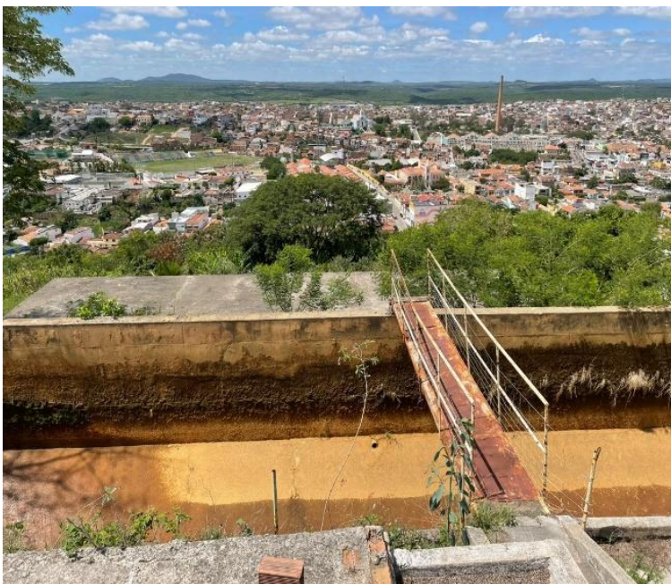
Figura 07: Foto do tanque de lavagem da ETAR-Afetos, visto por outro ângulo.
