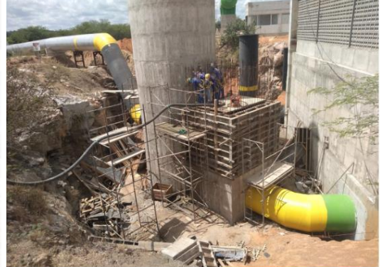
Foto 6 - Interligação na chaminé de equilíbrio
