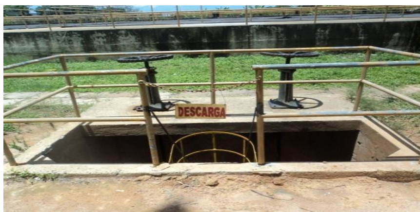
Figura 1.3 Foto do Ponto de Descarga de Lodo do Decantador
