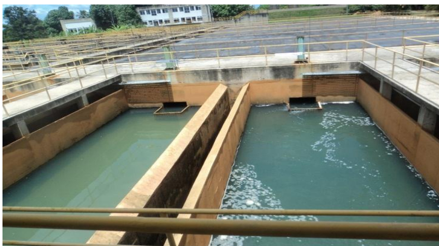
Figura 1.4 Foto dos filtros descendentes da ETA Botafogo
